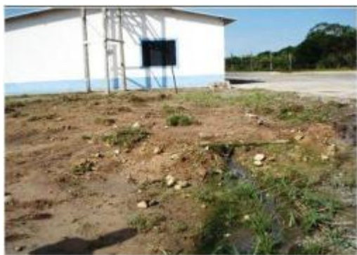
Foto 22: Visão geral do vazamento de esgoto
