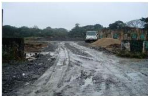
Foto 12: Canteiro de Obras e dormitório dos trabalhadores em área de APP
