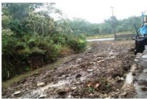
Foto 15: Canteiro de Obras em área de APP
